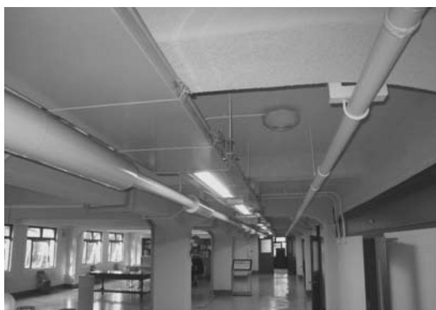
写真6 段違いラック+薄型照明器具
