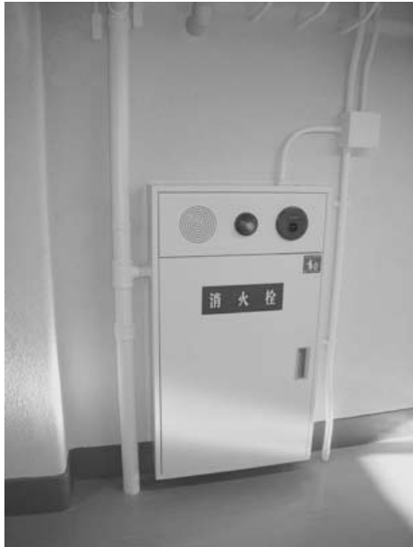
写真10 屋内消火栓設備(既設再利用)
