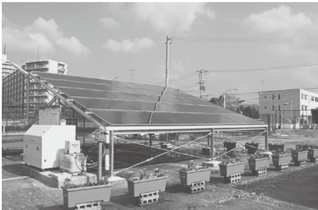
くるくる市民発電所
