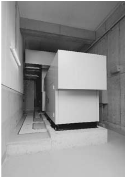
写真7 車庫・道場棟発電機室
