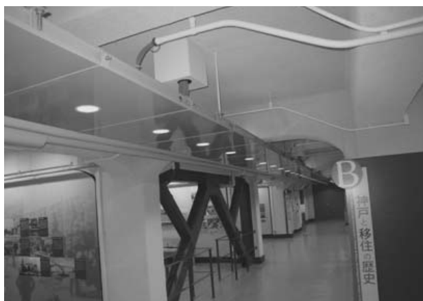
写真5 配線ラック埋込みダウンライト
