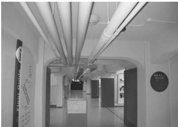
写真11 露出冷媒配管(鋼板製ラッキング)
