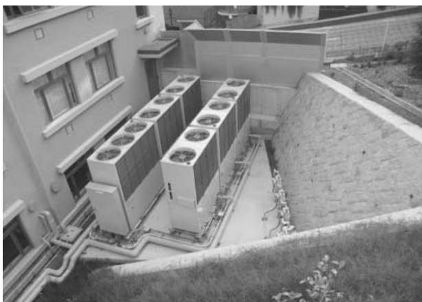
写真12 室外機置場(下部に消火水槽)
