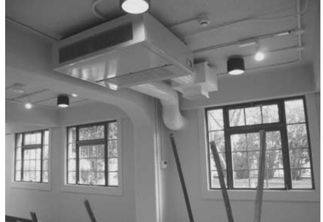
写真13 露出ダクト(鋼板製ラッキング)
