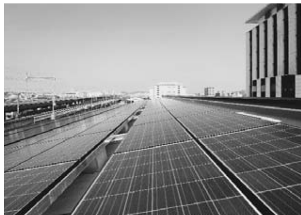
写真10 太陽光パネル
