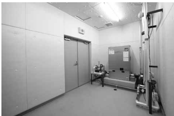
写真 12 住宅用ポンプ室
