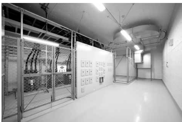
写真 13 住宅用電気室
