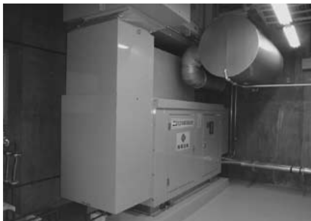
【非常用発電設備】
