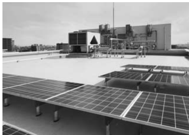
【太陽光発電設備】
