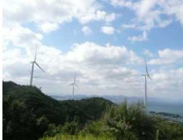
風力発電設備
