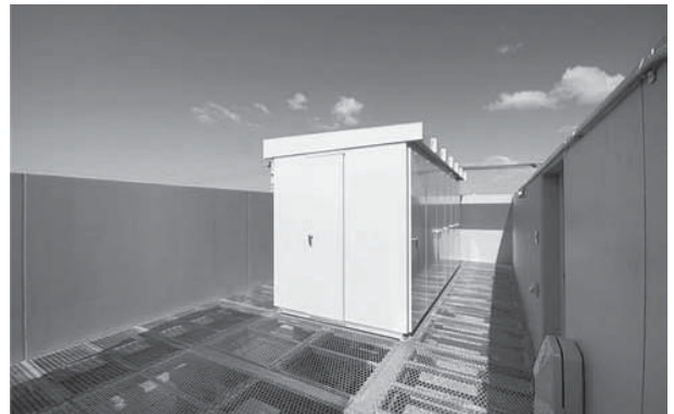
屋外キュービクル
