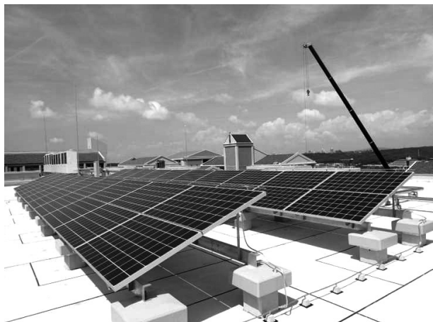
【屋上太陽光発電設備】
