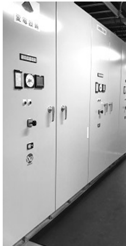
屋内キュービクル
