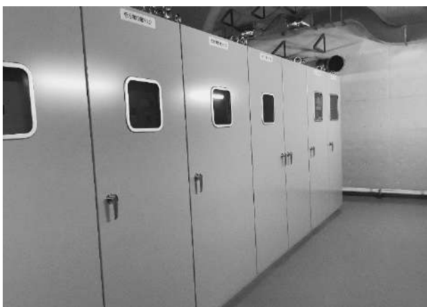
【体育館兼特別教室棟4階電気室】
