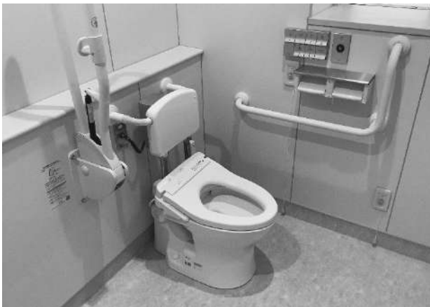
【多目的トイレ】
