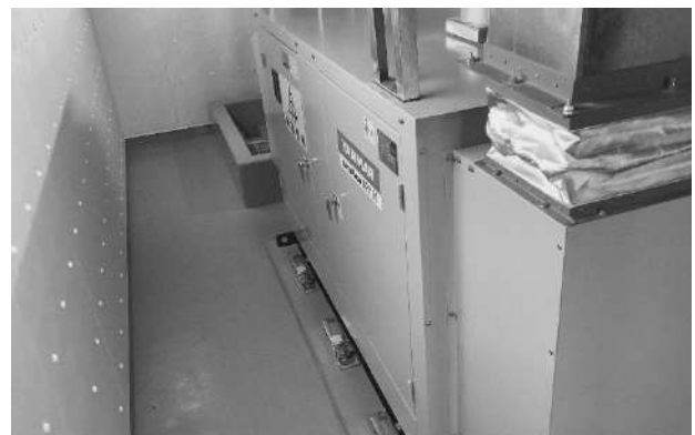
【体育館兼特別教室棟4階発電機室】
