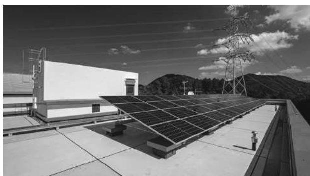
【屋上 太陽光発電パネル】
