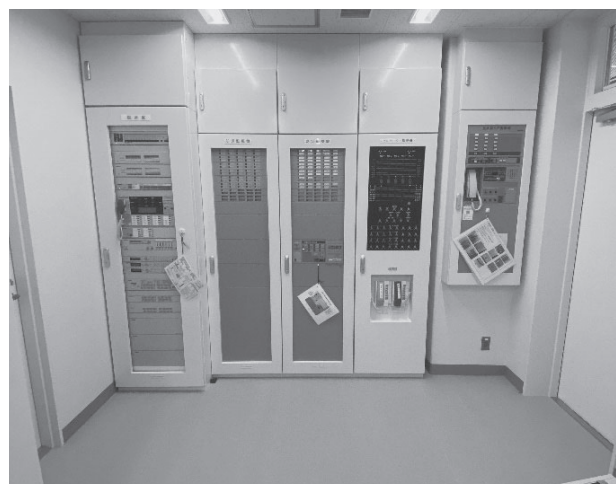
1階 中央管理室
