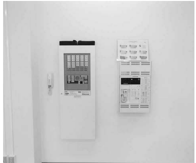
【拡声設備・防災設備】
