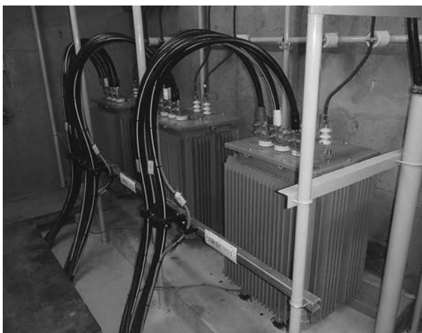
【トッランナー変圧器】
