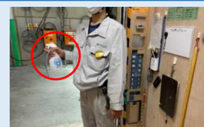
EVの操作盤等の消毒を徹底
