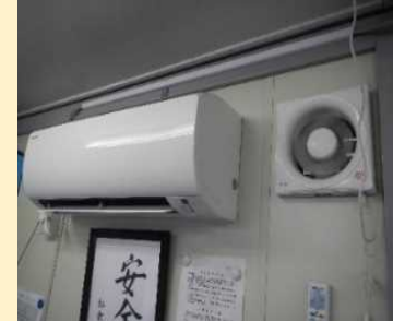
扇風機や換気扇とエアコンを併用
