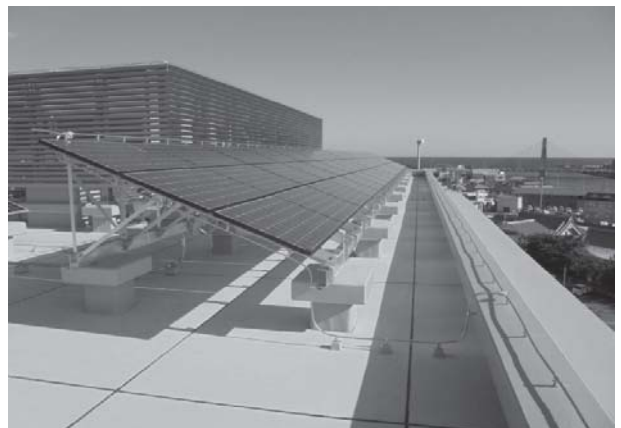
【屋上階太陽光発電設備】
