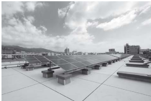
太陽光パネル
