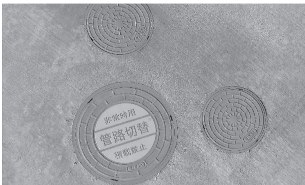
排水経路切替柵
