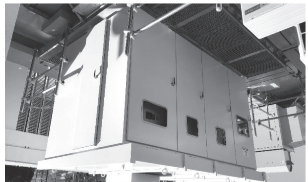
屋外キュービクル
