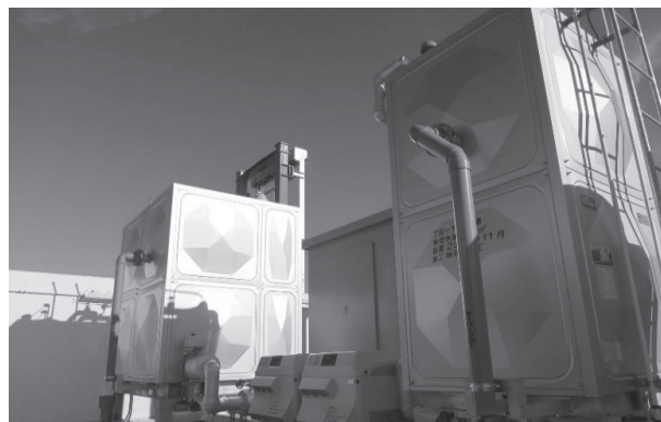
受水槽、雑用水槽
