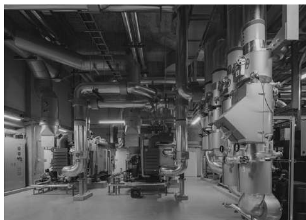
吸収式冷温水機
