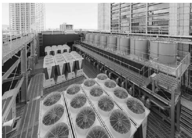
冷却塔・空冷ヒートポンプモジュールチラー
