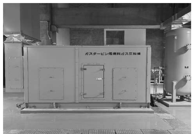
発電機室ガス圧縮機
