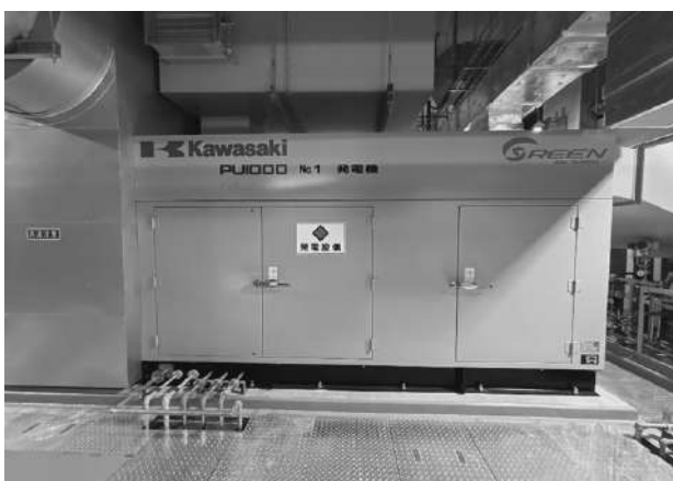
発電機室発電機
