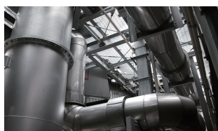
プラント配管
